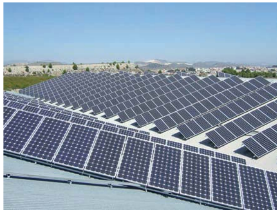
Cehegin, Murcia. 600KW. / Cehegin, Murcia. 600KW.
